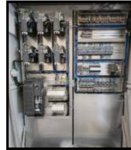
Siemens Elektrik Panosu
