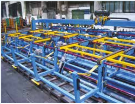
Panoramica dell'impianto View of the plant
