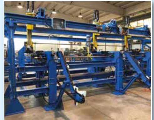
Panoramica dell'impianto View of the plant
