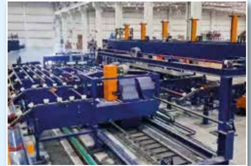
Vista dell'impianto View of the plant
