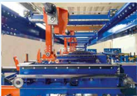
Vista dell'impianto View of the plant
